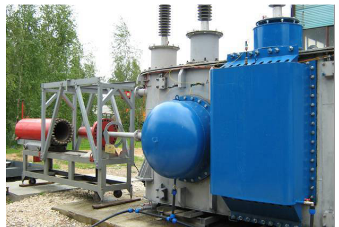
Рис. 14. Автотрансформатор с системой динамической защиты до испытаний
